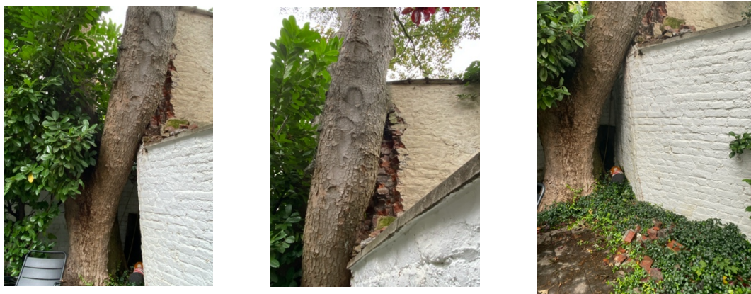
Figure 4: dégâts provoqué par l'arbre au niveau du pignon de la maison voisine et du mur mitoyen
